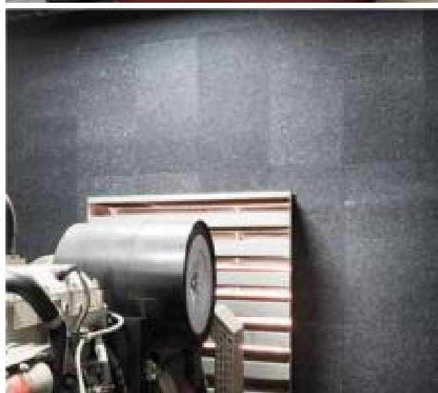
Casa de máquinas
